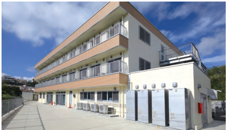
建物西側に設置されているエコキュート
