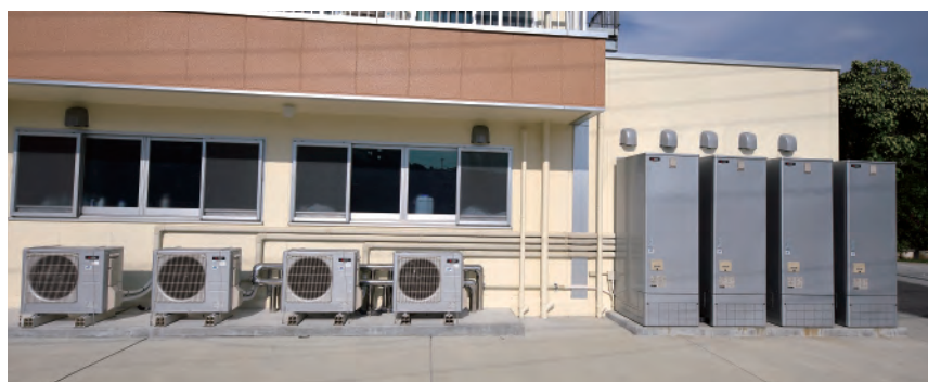
4台のエコキュートを連結し、浴室の給湯で使用。
