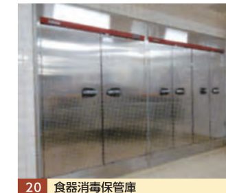
20 食器消毒保管庫
