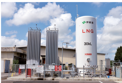
LNGサテライト
