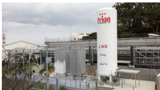
LNGサテライト設備 LNG貯槽70kl、気化器800kg/h
