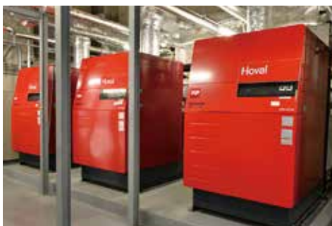
温水ボイラ(711kW×3台)
