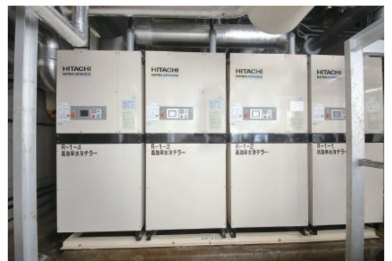
【機械室】高効率水冷チラー(4台)
