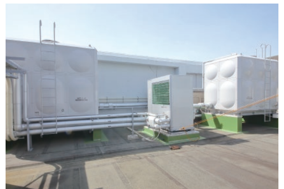
【屋上】高効率高温水ヒートポンプと貯湯槽(2台)
