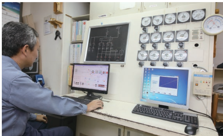
【中央監視室】監視操作盤
