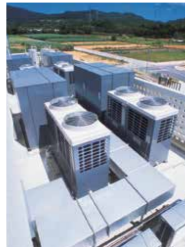
氷蓄熱式空調システム 20馬力×3台 16馬力×1台
