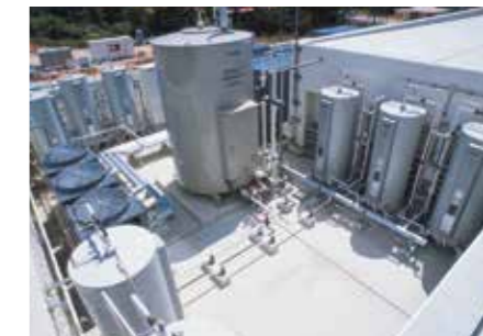
電気温水器 5,000L×1台 550L×9台
